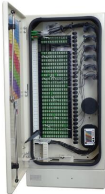
Hub de Distribución de Fibra. Gabinete PON de 144, 288 puertos. Gabinete de conexión cruzada de 432 puertos
